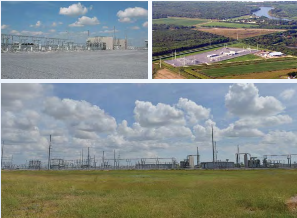
Foto de equipo DC ubicado en Mission, TX, a lo largo de la Frontera entre Texas y México.
