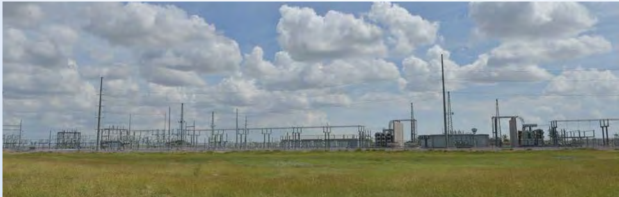
Foto de equipo DC ubicado en Mission, TX, a lo largo de la Frontera entre Texas y México.
